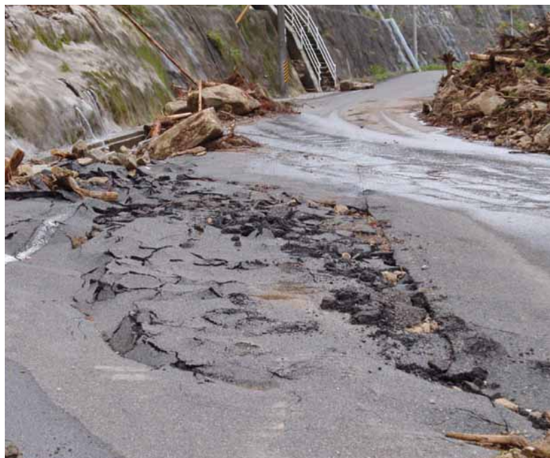
道路滑落現場（熊野市）
